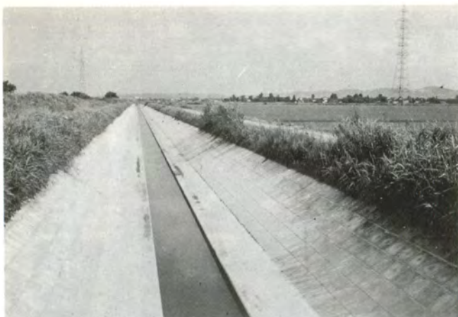
東部2号幹線排水路(下流から望む)
