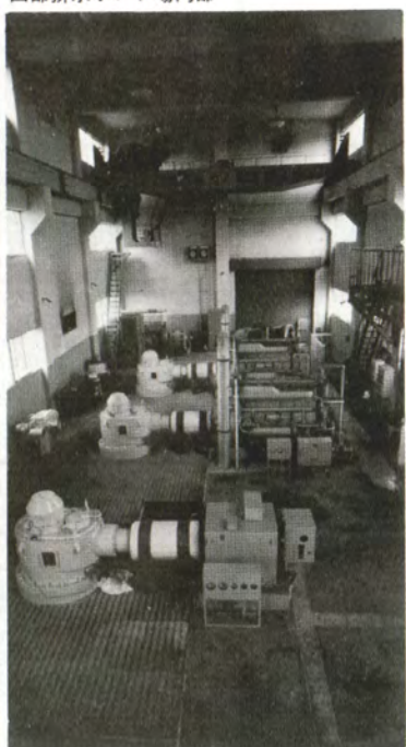
西部排水ポンプ場内部
