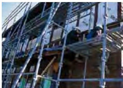
施主と相談しながらプランを練り上げ、5月の完成をめざして施工する。伝統工法を現場で学びながら、体で覚えていく学生たち。
