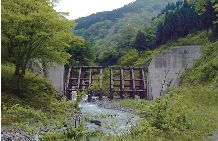
透過型砂防堰堤 (境川) [朝日町]
