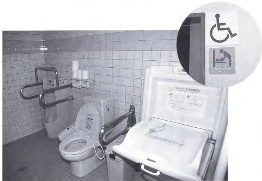
障害者、高齢者、子ども連れなど、誰にでも便利な多目的トイレ
