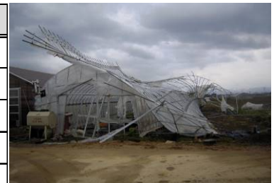
図 ハウスの損壊
