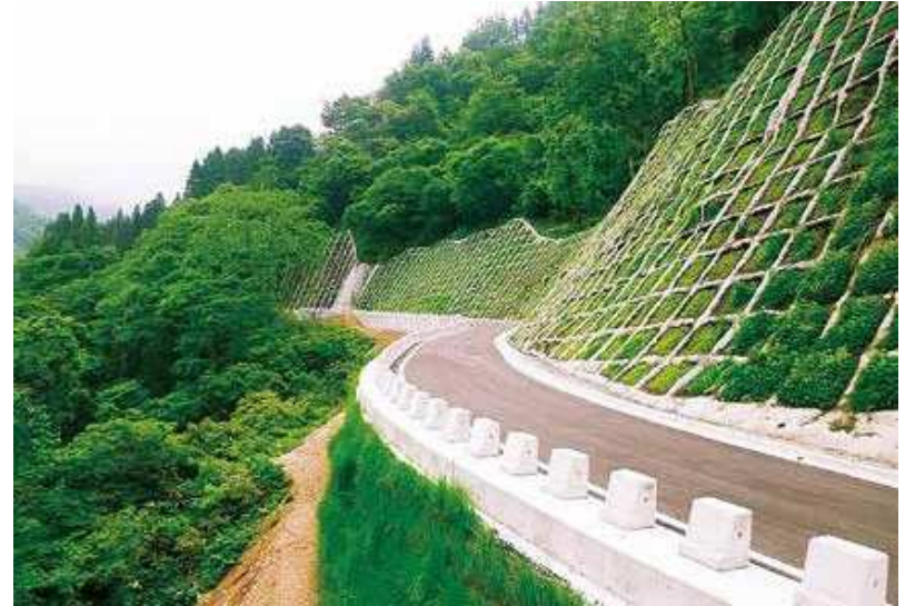
(株)ユアネクス施工の「県営林道開設別又嘉例沢線一ノ又谷工区開設工事」
