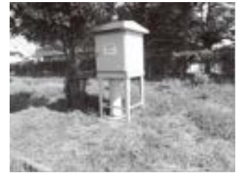
地下水位観測井
