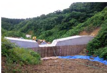
治山ダムにおける残存型枠
