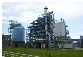
木質バイオマス発電所 (射水市内)
