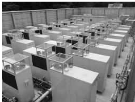
消化ガス発電施設
