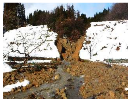
破堤したため池(氷見市)
