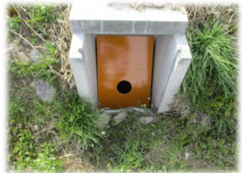
調整板を設置した様子(田んぼダム)
