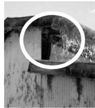
防鳥ネットの破れと鶏舎の壁の破損
