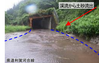
上畠地区(R4.8豪雨による土砂流出)
