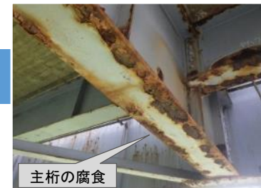
主桁の腐食 橋梁の老朽化対策 (県道新湊庄川線 雄神橋の損傷状況)
