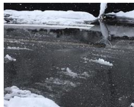
図 7-26 地下水を利用した消雪設備
