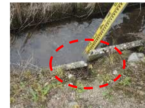
用水路劣化状況(BF欠損)
