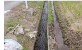
用排水路からの漏水状況
