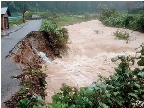
笹川の護岸欠損
