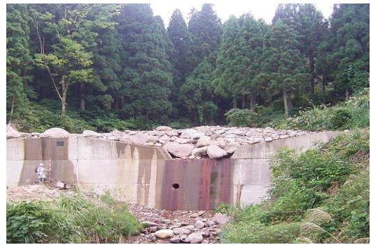
土石流を捕捉した治山ダム工
