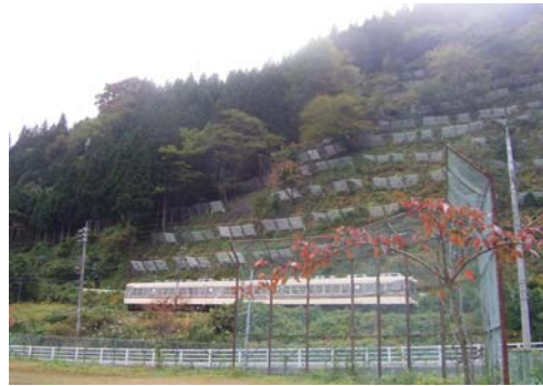
なだれの発生を予防する吊柵工
