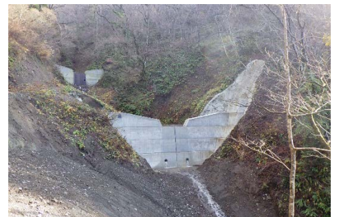
崩壊地の荒廃地復旧 (南砺市入谷)
