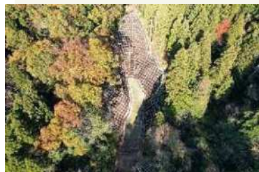
崩壊地の復旧
