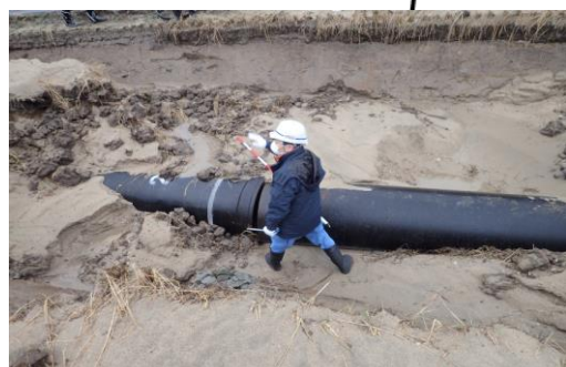
液状化による管水路・農道の被災 (氷見市)
