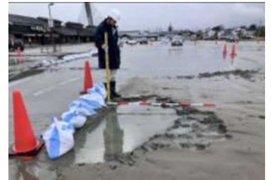
ひみ番屋街 駐車場の液状化
