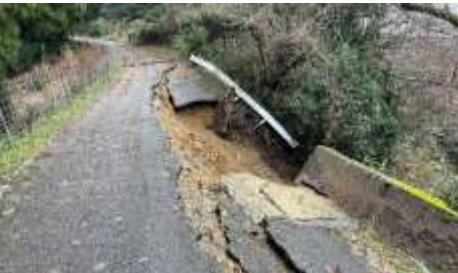
林道の路肩崩壊 (氷見市論田地内)
