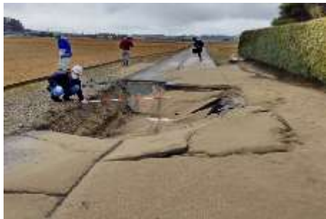
液状化により管水路・農道が被災 (氷見市飯久保地内)
