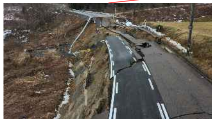
崩落した国道359号（小矢部市）
