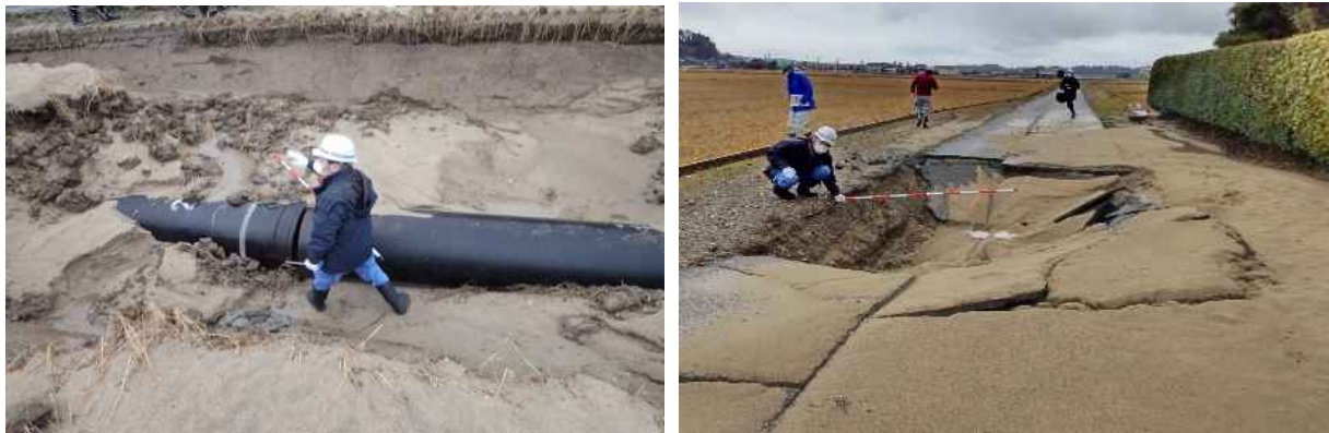
図表15 管水路・農道 液状化被害（氷見市）
