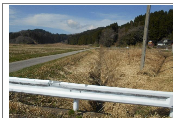
(子供があがれない深い排水路)
