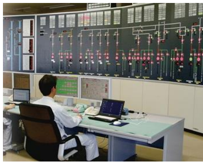
発電制御所（監視制御室）
