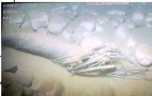
海洋深層水取水管断絶（氷見市）
