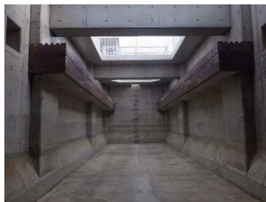
内観 (最終沈殿池)
