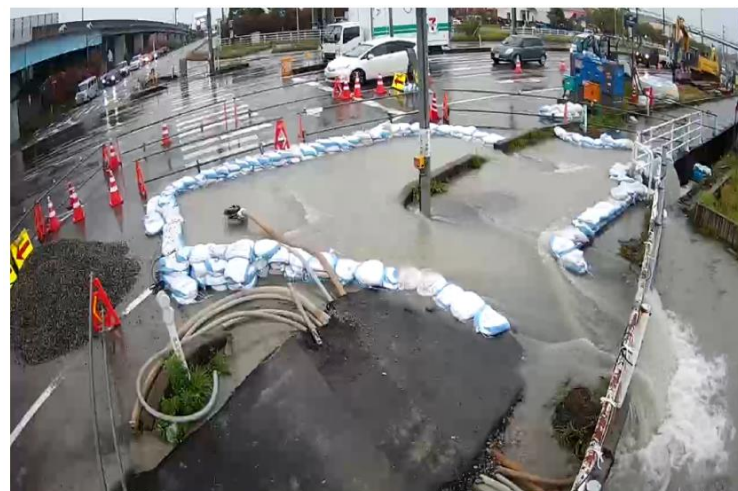
断水を伴う漏水事故
