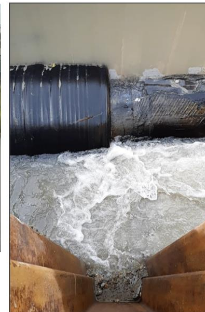
管路をつなぐゴム製の継ぎ目の劣化が漏水の主要因
