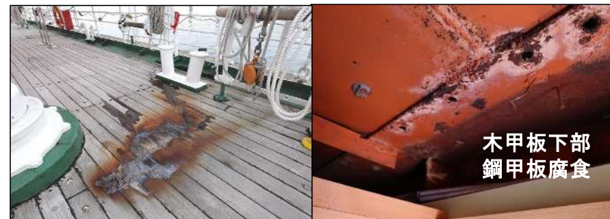
木甲板腐食及び下部の鋼板腐食
