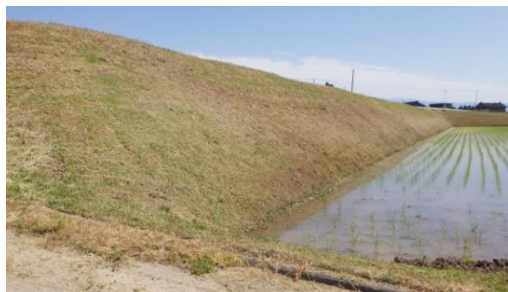
傾斜が急な法面
