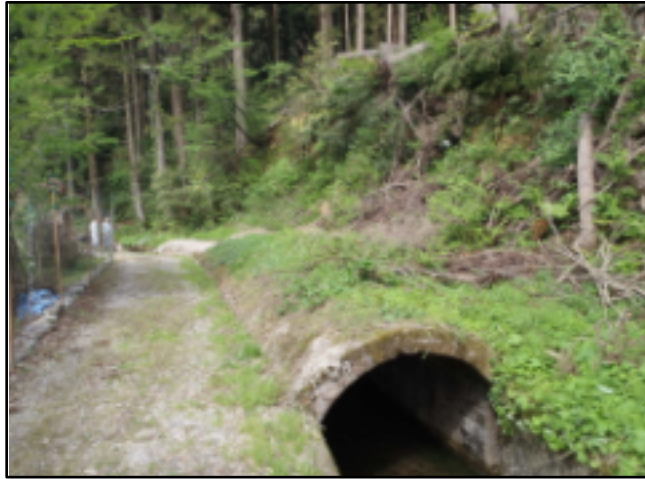
老朽化して改修が待たれる天神野用水路
