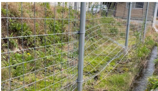
柵裾部の押上げによる破損
