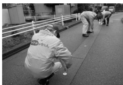
地下水の守り人の活動状況 （消雪設備の点検）
