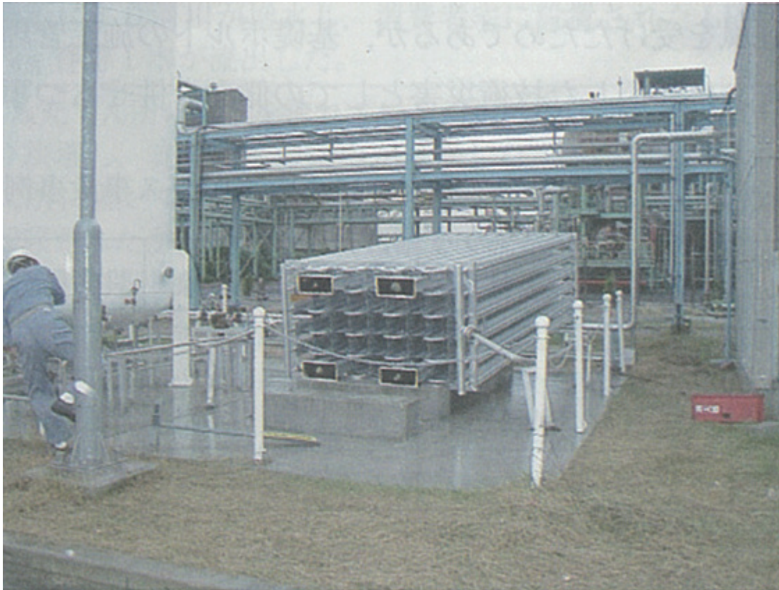
送ガス蒸発器の転倒状況
