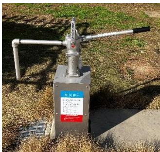
防災井戸 (県庁舎敷地内)
