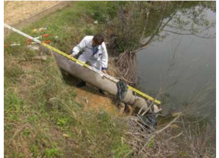
改修が待たれるため池施設 (富山広域地区:富山市山田工区)
