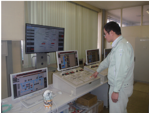
水管理システムによる用水管理 [小矢部川上流用水土地改良区]
