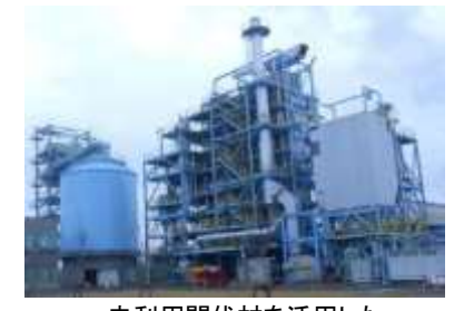
未利用間伐材を活用した 木質バイオマス発電施設 射水市、出力5,750kW (株)グリーンエネルギー北陸
