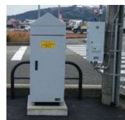
信号機電源付加装置
