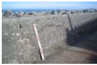
護岸老朽化状況
