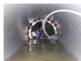
下水道施設の機能維持
