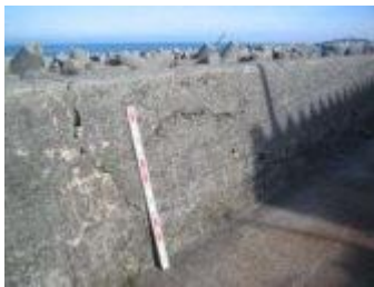
護岸老朽化状況
