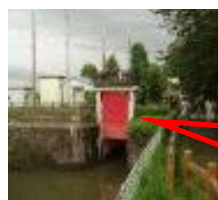
老朽化状況（松川水門）
