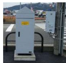
信号機電源付加装置
