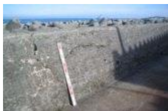
護岸老朽化状況
