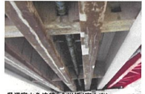
県道富山魚津線 今川橋(富山市) 現橋の損傷状況
