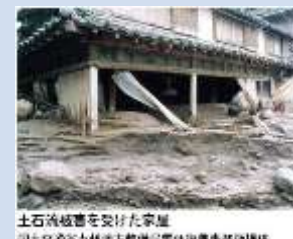
土石流被害を受けた家屋 国土交通省中部地方整備局の記録カメラによる
