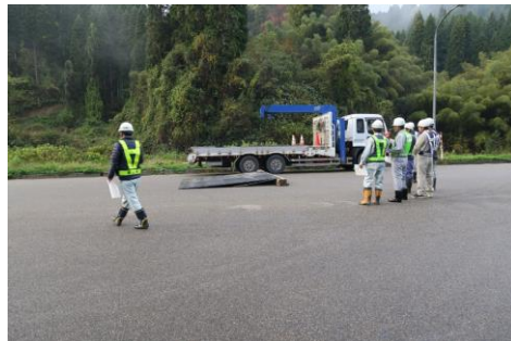
道路の段差被害を確認・作業調整 (氷見市 国道415号 谷屋地内)
