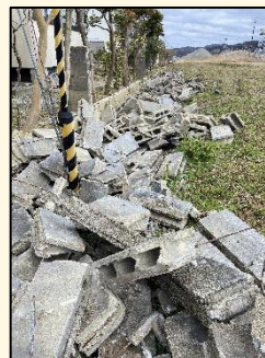
崩れたブロック塀
