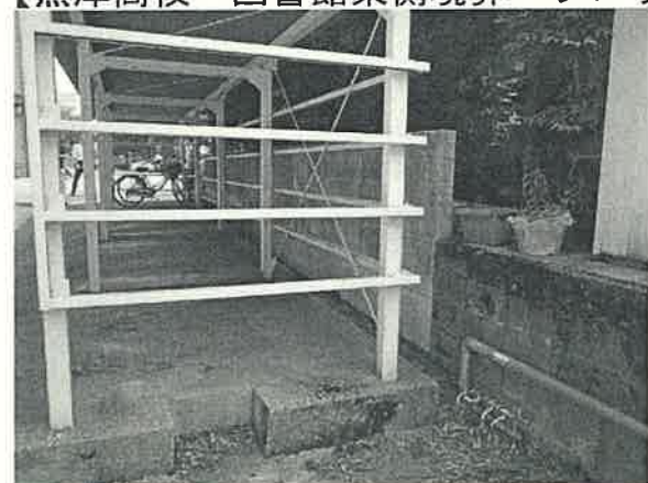
【魚津高校 図書館東側境界 ブロック塀】
