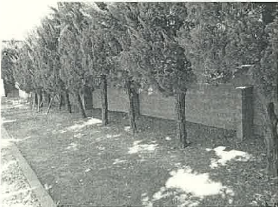
【高岡商業高校 双龍ハウス（食堂）東側境界 ブロック塀】
